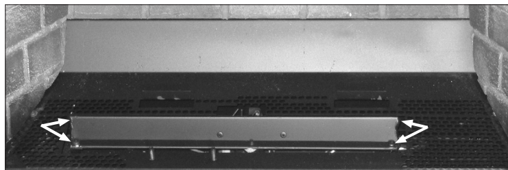
Figure 14: Desserrage du brûleur.
