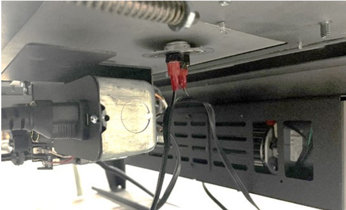
Figure 7.9, Emplacement du commutateur de contrôle de la température
