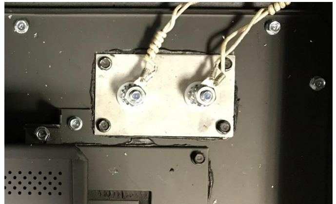
LES DEUX LAMPES SONT BRANCHÉES
